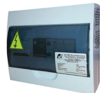
Шкаф управления ШСАУ-В
