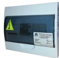
Шкаф управления ШСАУ-В
